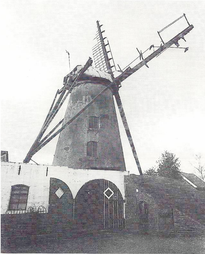
Het troosteloze resultaat van langdurige stilstand en geen onderhoud!
