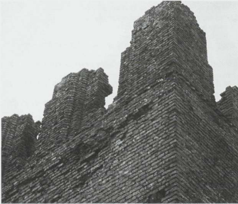
De bovenkant van de toren, met gevaarlijk loszittende steen.
